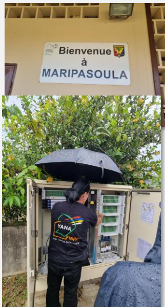
Visite d'un PM déployé par Yanafibre dans le cadre de la DSP
